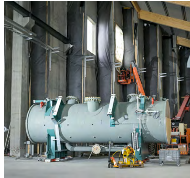
Die hochmoderne Großwärmepumpe am Gelände der ebswien Kläranlage ist ein wesentlicher Schritt in Richtung der klimaneutralen Fernwärmeerzeugung in Wien.
