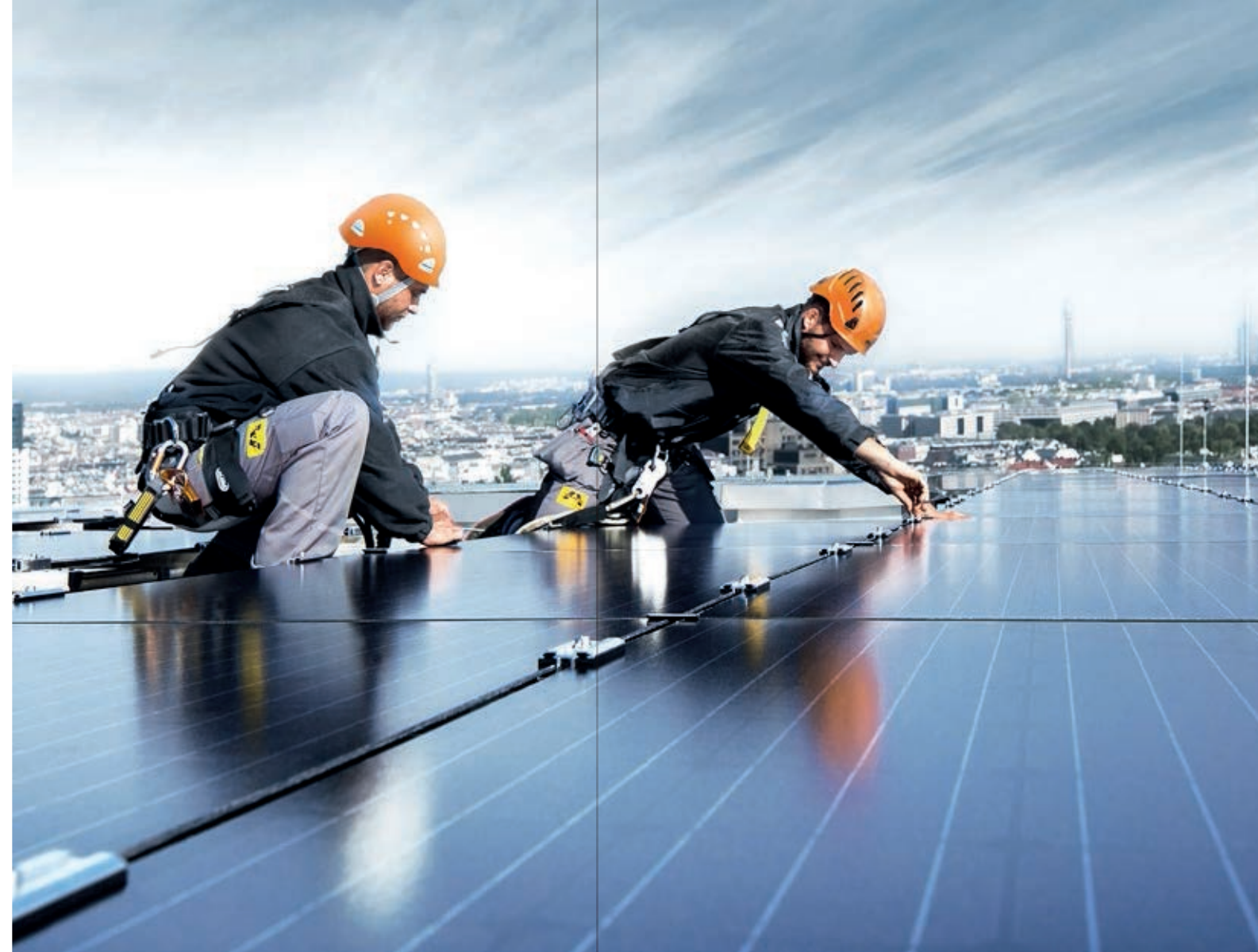
Energieeffizienz auf allen Ebenen durch neue Produktideen und Weiterentwicklungen.
