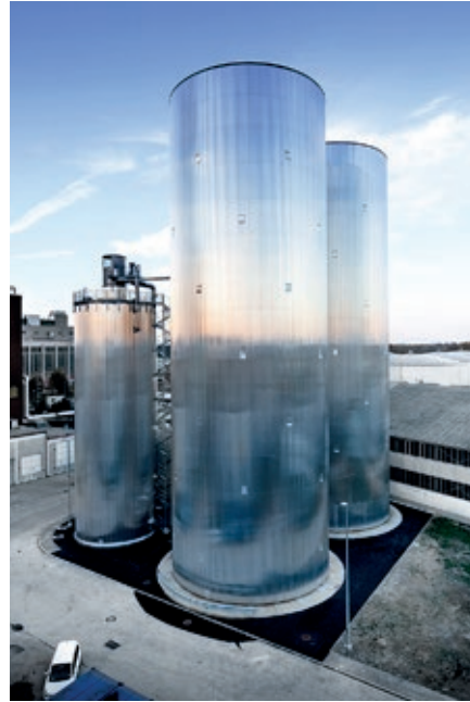
Wärme, wenn sie benötigt wird: Hochdruckwärmespeicher in Wien Simmering.
