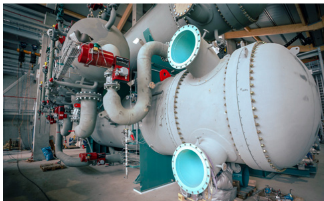
Mit einer der leistungsstärksten Großwärmepumpen Europas , die am Gelände der ebswien-Kläranlage in Simmering errichtet wird, produzieren die Wiener Stadtwerke klimaneutrale Fernwärme.
